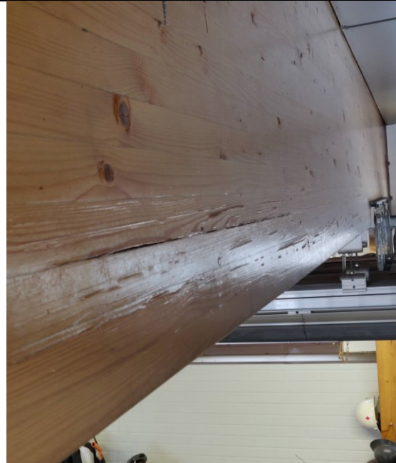
Liimapuupalkit ovat suoria, halkeamat ovat pintahalkeamia.
