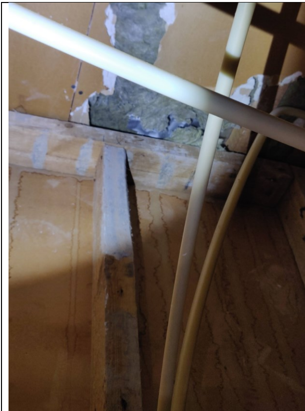
Yläpohjan eristeitä, vanha vesivahingon kohta
