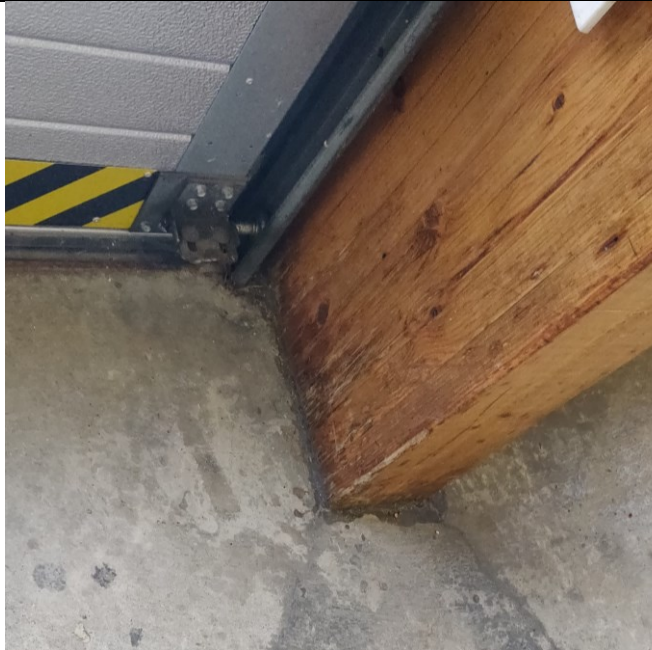
Liimapuupilarien alapäävät ovat alapohjalaatan sisässä, ja altistuvat kosteudelle
