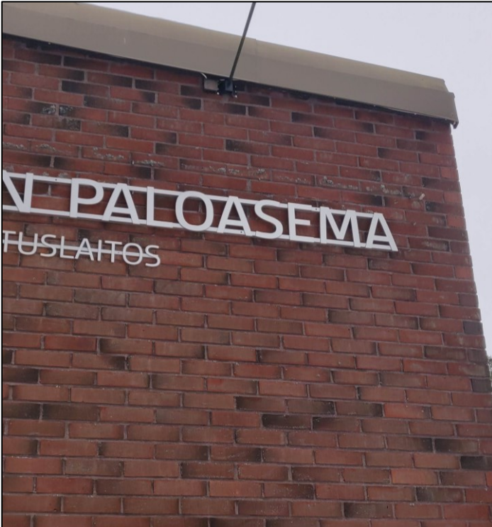
Julkisivumuuraus, jäkälää ja kosteuden aiheuttamaa tummumaa
