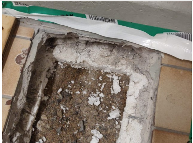
Rakenneavaus, pesutila. Lattiassa ei ole vesieristeitä. Täyttöhiekkä märkää.
