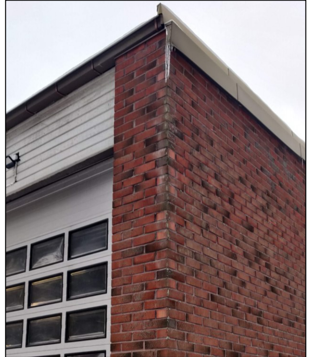
Nurkissa ei ole syöksytorvia, räystäskourut ovat tulvineet yli ja kastelleet nurkkia
