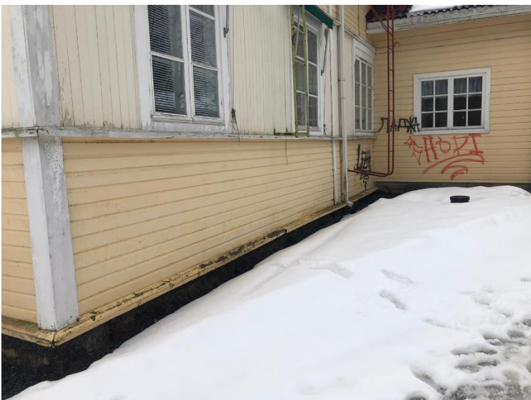
pääsisäänkäynnin matala betonisokkeli ja kulunutta julkisivua
