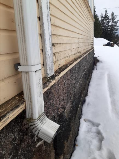
julkisivun kulunut tippalista. Syöksytorvi heittää vedet perustuksille
