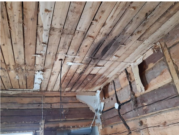
vuotaneen vesikatkon aiheuttama vaurio yläpohjassa
