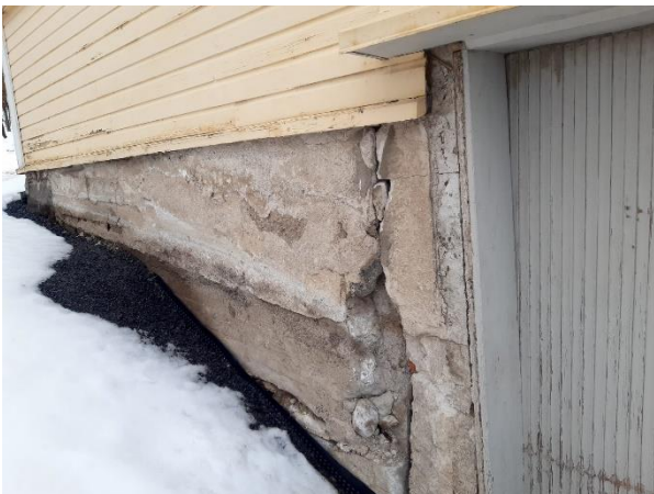
Itäpäädyn murtunut betonisokkeli
