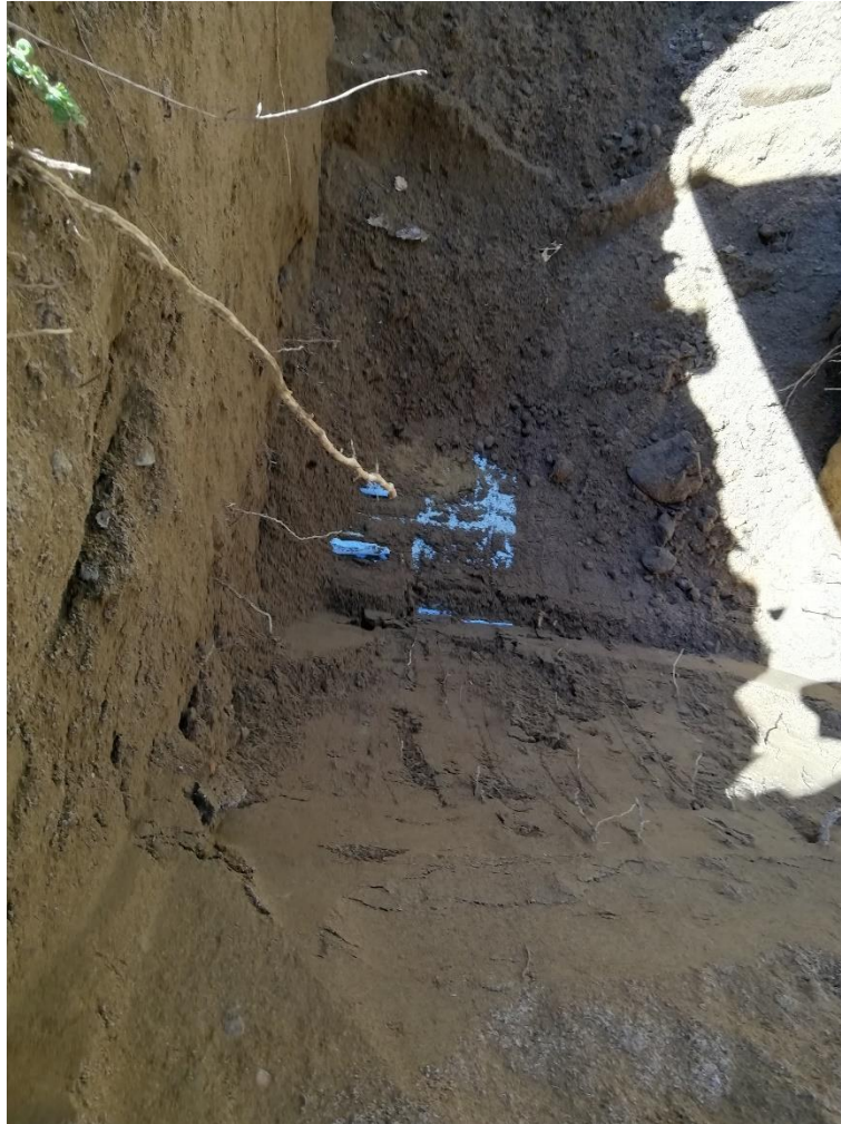
Kuva 7. Näytepisteen TS2 havaitut routaeristeet.
