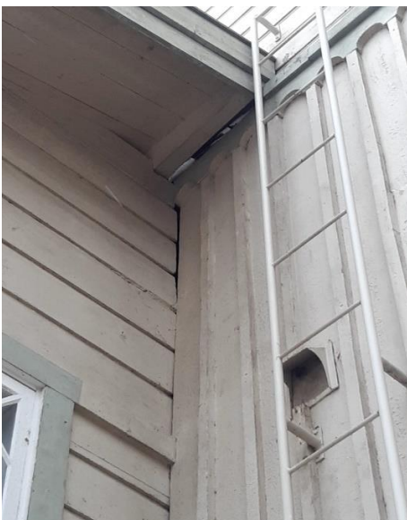
idänpuoleisen kuistin ja rakennuksen päädyn liitoskohdan rako
