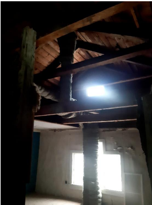
yläkerran päädysssä kulkeva ilmanvaihtokanava
