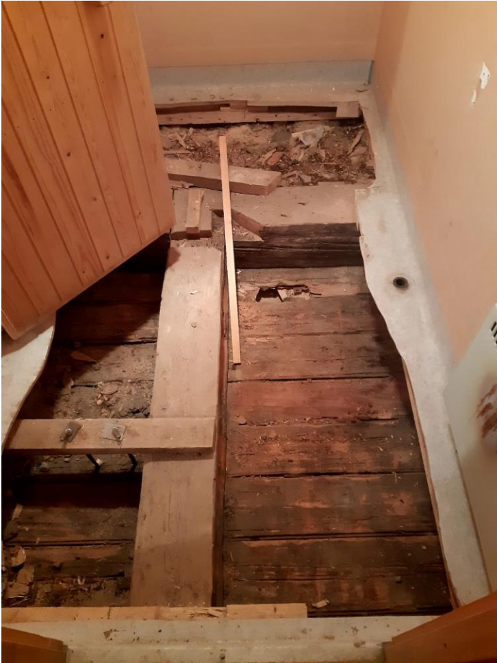
yläkerran märkätilan vaurio
