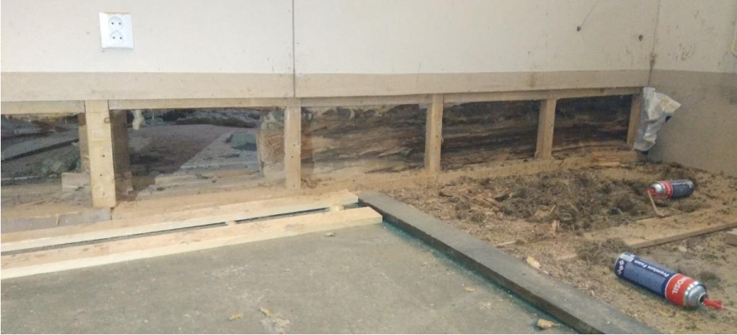
pahoin vaurioitunut väliseinä, jossa näkyvissä seinän peittävä lisäkoolaus levytettynä
