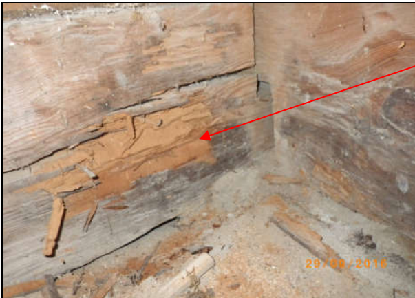
Kuva 1. Lahovaurioita hirressä tienpuoleisessa kulmassa ryömintätilassa.
