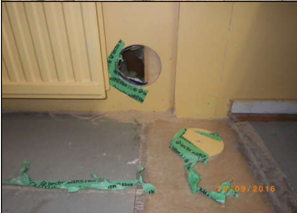
Kuva 2. Rakenneavaus ulkoseinässä juhlahuoneessa.
