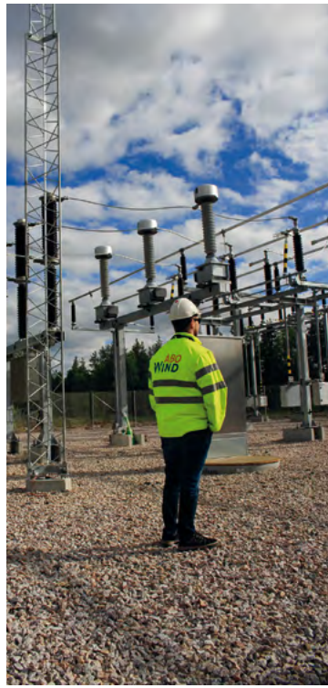
Verkkoliitäntä ja sähköasema
