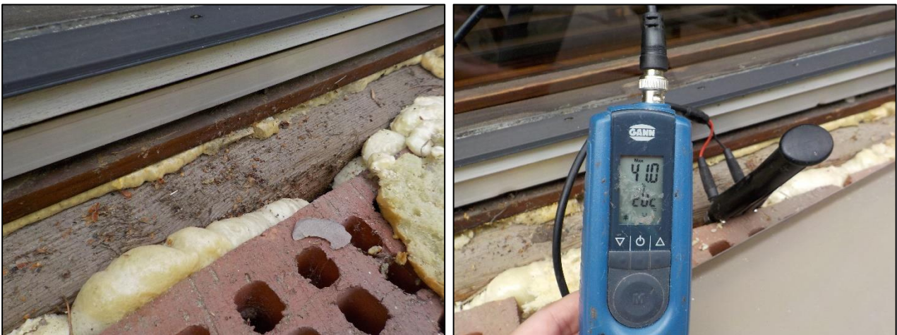
Kuva 2.1. Yleiskuvia vesipellin avaukseen liittyen. Mikrobinäytteen P1 läheisyydessä pellin alta havaittiin, että ulkoseinän tuuletusväliä on suljettu polyuretaanivaahdolla, mikä heikentää merkittävästi rakenteen kuivumista.
